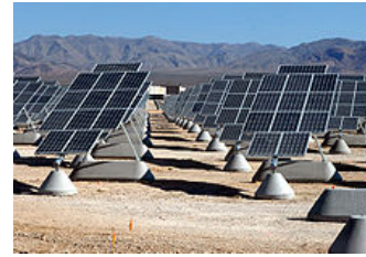
Nellis Solar Power Plant at Nellis Air Force Base in the USA. axis.
